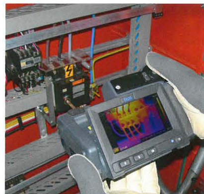
Untersuchung einer Schaltgerätekombination (Steuerschrank). Das Bild der Kamera zeigt den Schütz und Wärmepaket. Die Anlage befindet sich im Betriebszustand und weist keine thermische Auffälligkeit auf. Die Anlage kann gefahrlos weiterbetrieben werden.
