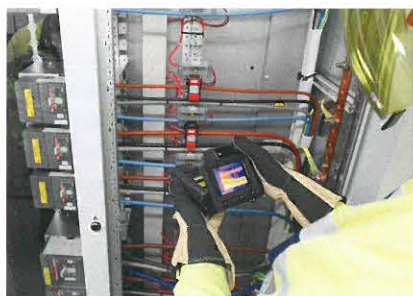
Untersuchung einer Schaltgerätekombination (Grobabgänge). Das Bild der Kamera zeigt eine thermische Auffälligkeit auf dem Polleiter L3. Die schlechte Verpressung des Kabelschuhs wurde richtiggestellt und die Anlage kann gefahrlos weiterbetrieben werden.
