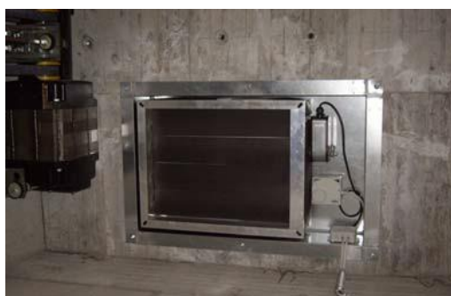
Figure 23 : Clapet d'évacuation des fumées mesurée
