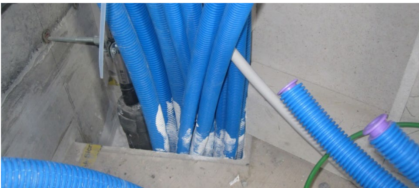
Abbildung 11: Nicht geeignet: Gebündelte Elektroinstallationen (Quelle: Hochschule Luzern – Technik & Architektur; Foto: 30.11.2013)
